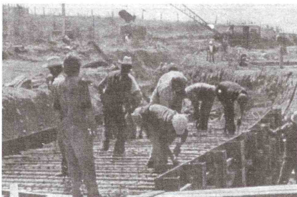
Ampliación del canal del Cerro del Cuatro.
